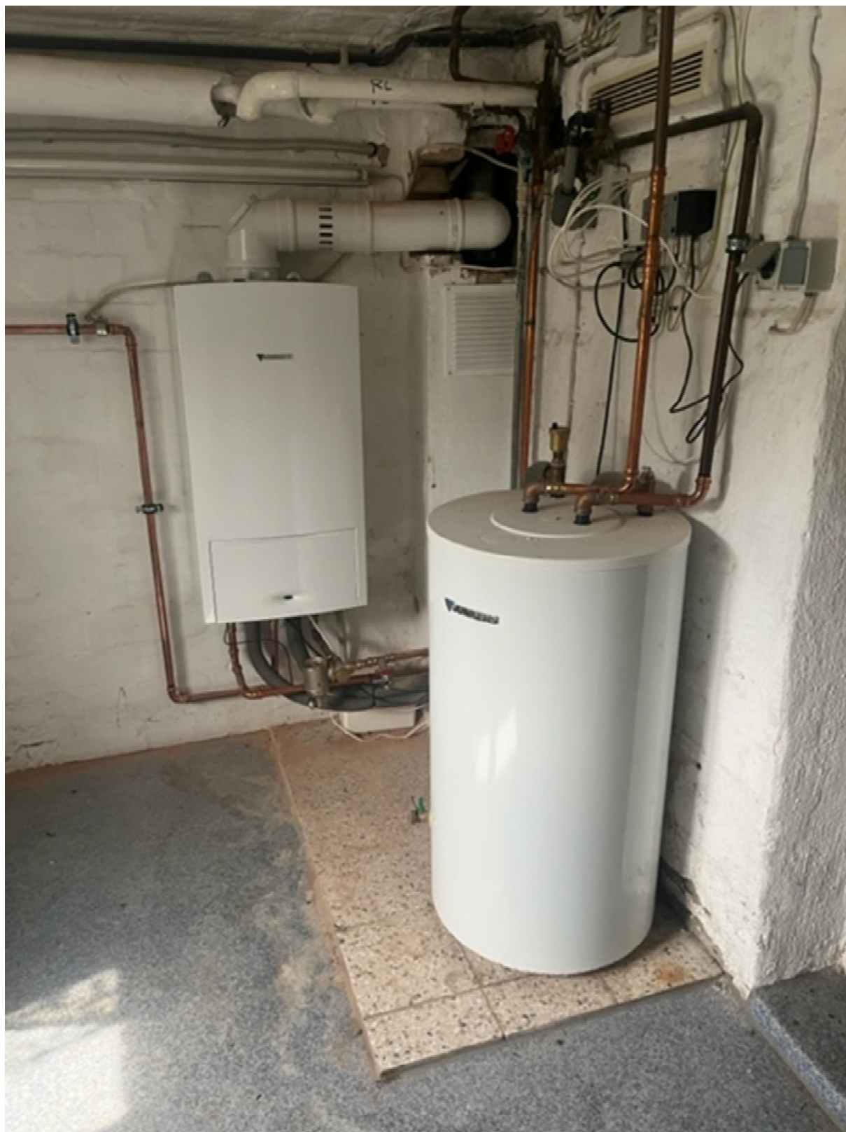
Gas-Heizung aus Baujahr 2022
